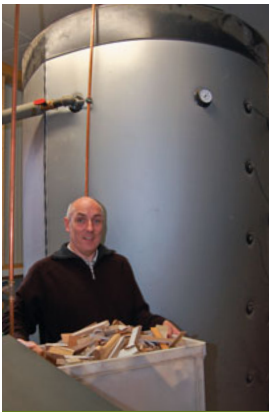
Tischlermeister Matthias Sieg vor dem Warmwasserspeicher seines Holzheizkessels. Hier können die Tischlereiabfälle nutzbringend verbrannt werden.
